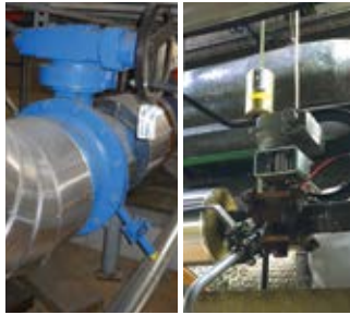
Odcięcie pompy DBB
