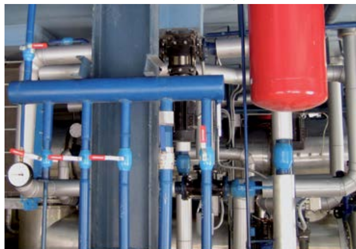
Węzeł ciepły (wyjście z wymiennika)
