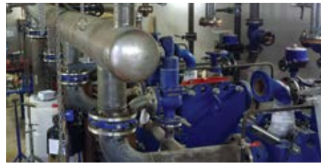
Węzeł ciepły (wejście do wymiennika)
